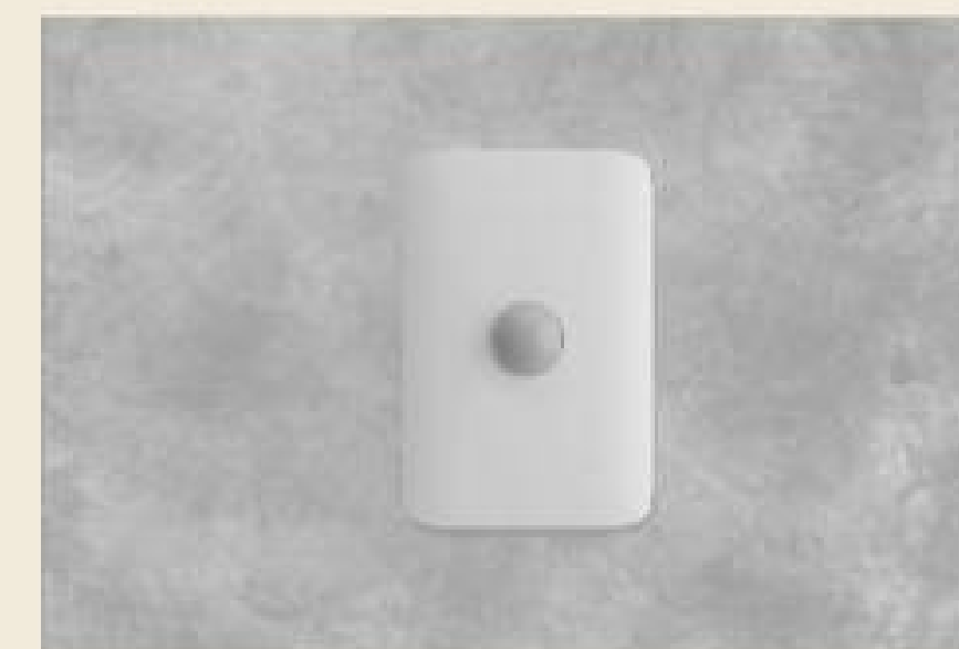
Sensores de presença nas áreas comuns
